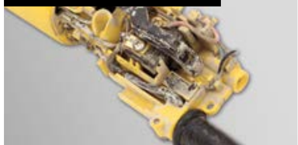
Uszkodzenie spowodowane przez wodę
